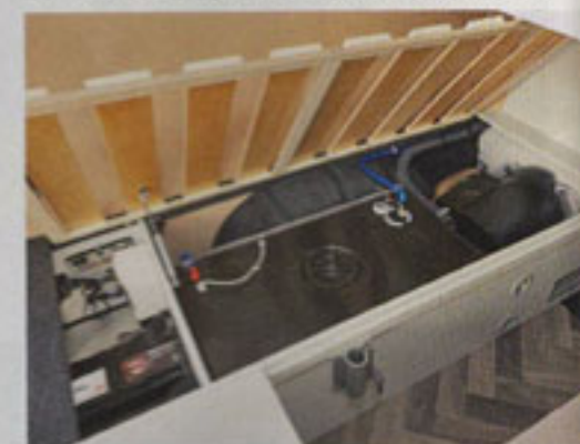
Der rechte Bettkasten nimmt Heizung, Wassertank und Bordelektrik auf.
